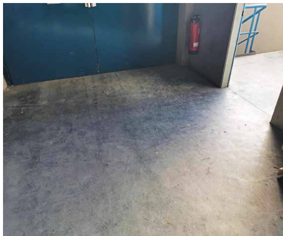
LINKS: Aufgrund der Trockenbaumaßnahmen war der Boden durch mineralische Stäube verschmutzt.
